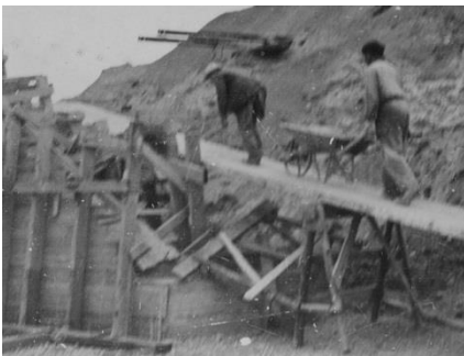
Afb. 36 De onderbroken spoorstaven steken uit het talud.
