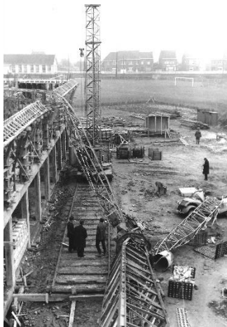
Afb. 380. Op de voorgrond de afgeknapte mast van de kraan met verderop waaivormig de giek, die over het gebouw viel, en de tegengiek met contragewicht die terecht kwam op de bestelwagen van de monteur. Op de achtergrond de op spoor opgestelde tweede kraan.
