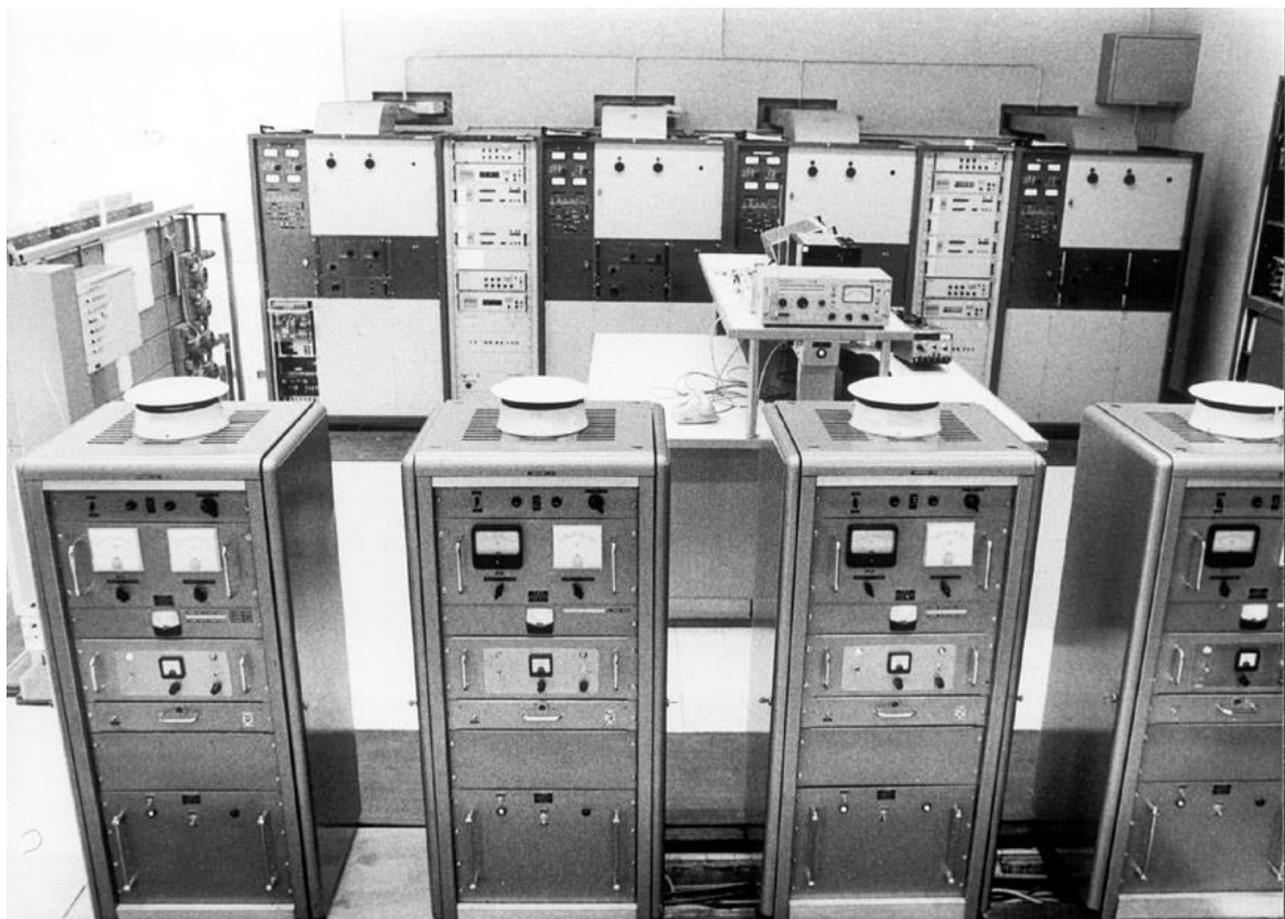
Zendcentrum Middelkerke1973: Vooraan de eerste VHF-zenders PYE/SMB voor simplex- kanaal 16 en duplexbedrijf kanaal 27 op metergolven (1962). Achteraan de middengolf 10 kW zenders Philips type RZ520.
